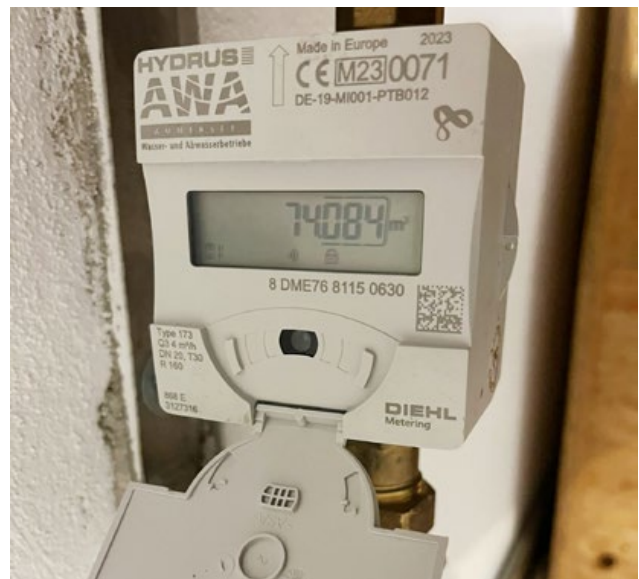
Verbauter Funkwasserzähler mit integrierter Temperatursensorenk. Quelle: AWA Ammersee
